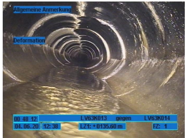
Abbildung 3-39: Kamerabefahrung - Starke Deformation einer Leitung, Foto: WBV Schweriner See/Obere Sude
