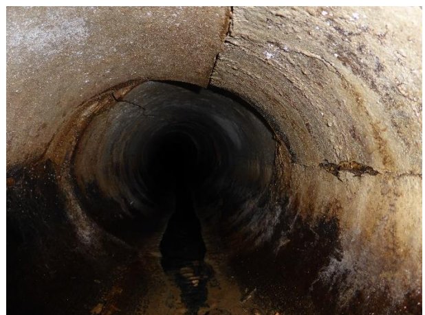
Abbildung 3-41: Rissbildung, Verformung bei einer Leitung; Foto: WBV Schweriner See/Obere Sude
